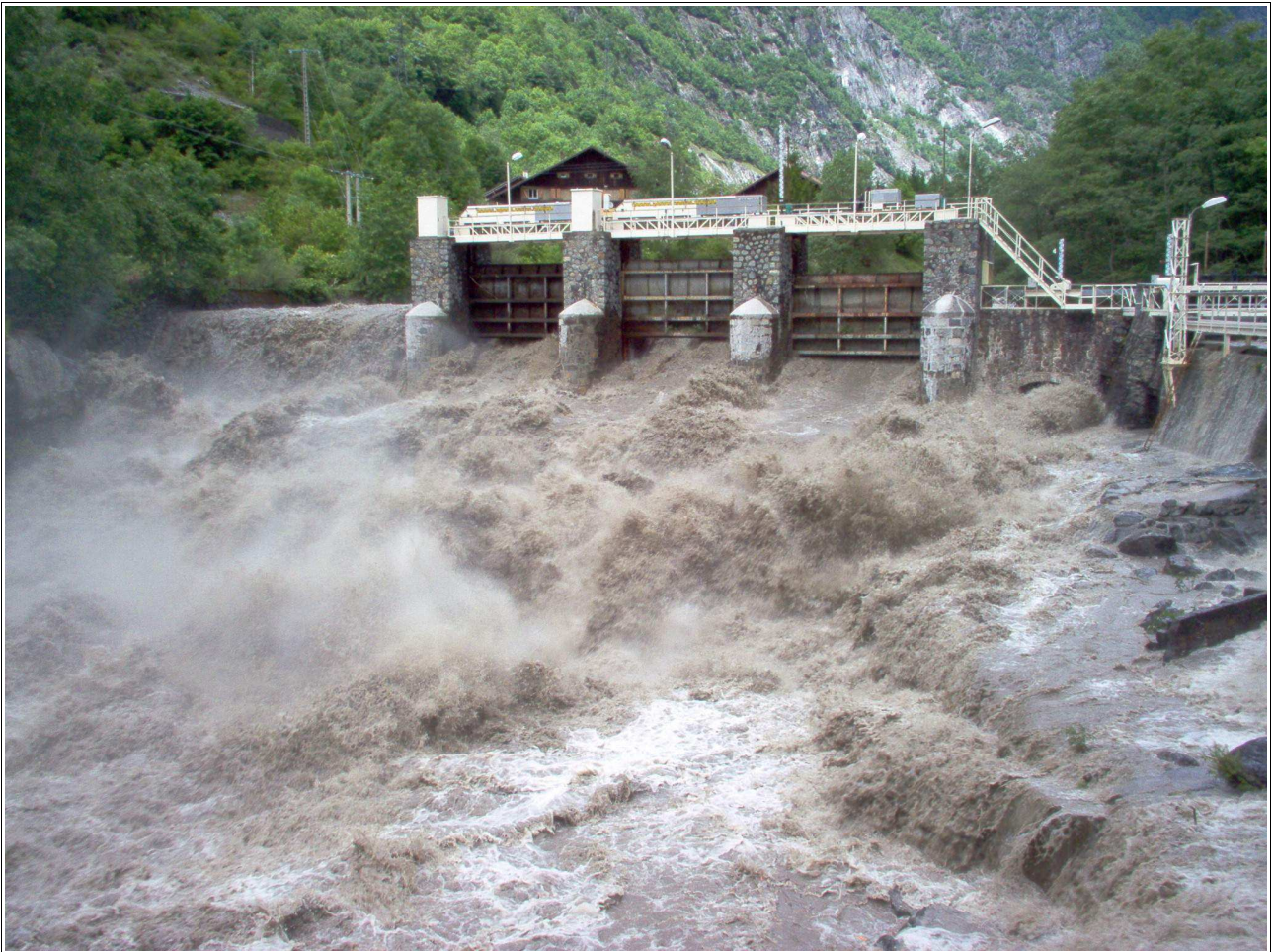
Photo 22 : Barrage de Séchilienne (Pierre Ebeyse) lors de la crue de la Romanche en Mai 2008. Syndicat Mixte des Bassins Hydrauliques de l'Isère.
