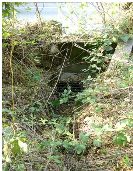
● 9. Entonnement amont sous-dimensionné du ruisseau de l'Acacia au droit de l'avenue Général Leclerc
