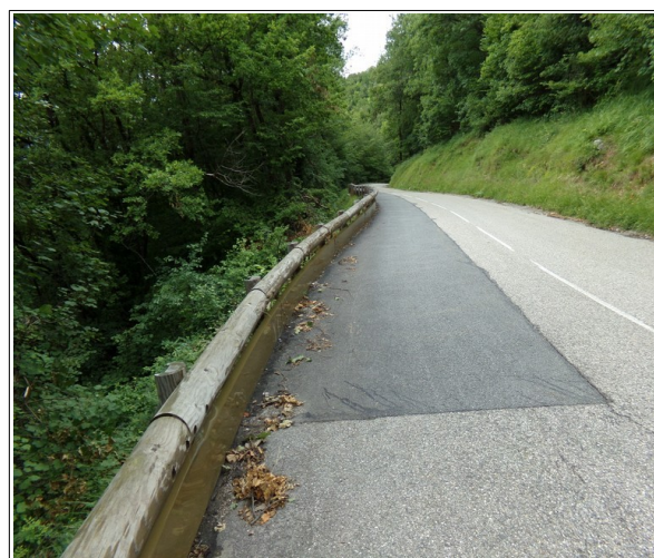
Photo 12: talus aval de la RD105d rétabli suite au glissement de 2005.
