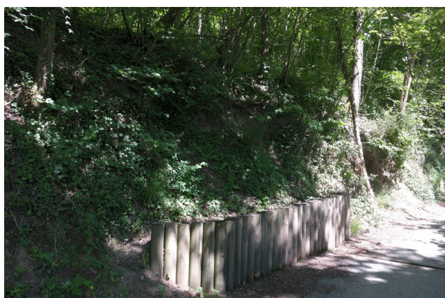
Photo 5: Déstabilisation du talus amont du chemin de Champaney.
