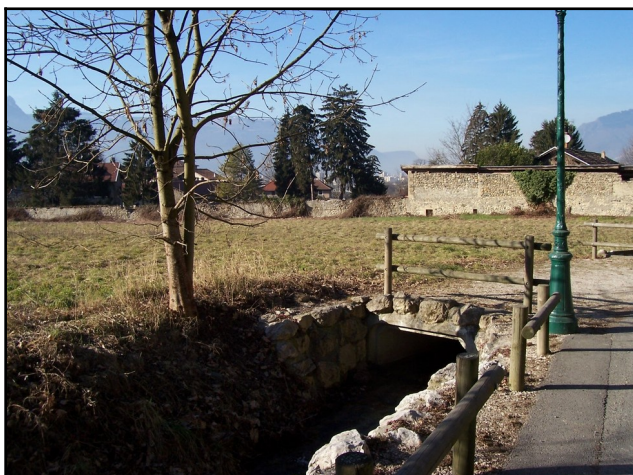
Photo 13: Mur de clôture limitant l'extension des divagations torrentielles. Noter le mauvais état de ce mur (brèches).
