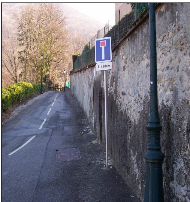
Photo 17 : Mur de soutènement montrant des indices de déformation le long de la rue de Montavie.
