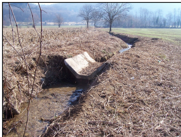
Photo 6: Affouillement dans le lit du ruisseau de Montavie à Pré-Bresson.
