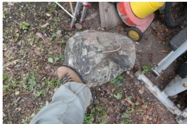
Photo 16: Pierre de 5 à 10 litres ayant atteint le cabanon de la parcelle B-976, endommageant le matériel stocké (volets roulant)
