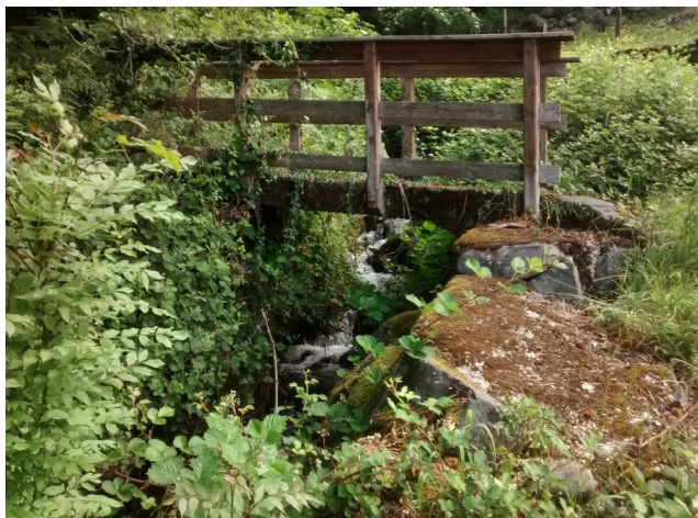
Photo 5: Passerelle béton sur le Bruyant à l'amont du hameau des Rivaux. Le lit est très embroussaillé.
