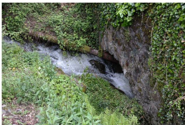
Photo 9: Pont du hameau du Château. On remarquera la conduite obstruant partiellement l'ouvrage.
