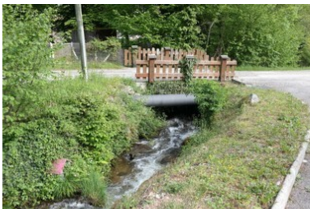
Photo 6: Ponceau de la Semilliere, on note le faible dimensionnement de l'ouvrage.
