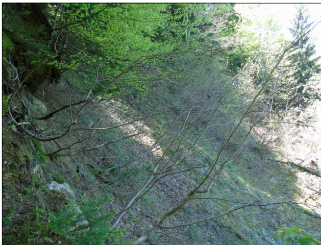
Photo 2 : Arbres penchés et paquets instables à l'aval de la niche d'arrachement du glissement de terrain du Prémol.
