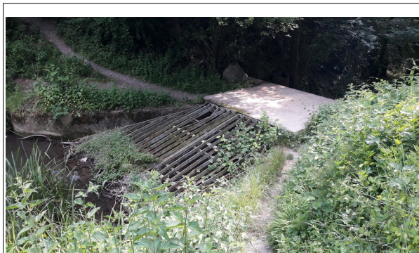
Illustration 3: Grille complémentaire PDD en avril 2017 légèrement endommagée
