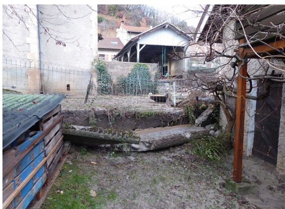
Photo 14: Murs d'enceinte effondrés au niveau de l'ancienne école suite à la crue du ruisseau de Combe Noire, le 4 janvier 2018
