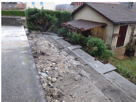
Photo 16: Mur effondré sous le café des voyageurs suite aux débordement du ruisseau de Combe Noire et du ruisseau de la Ferrière le 4 janvier 2018
