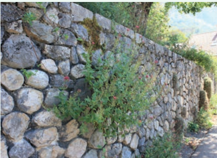
Mur à joint creux permettant l'implantation spontanée d'une flore et d'une faune - Mont-Saint-Martin
