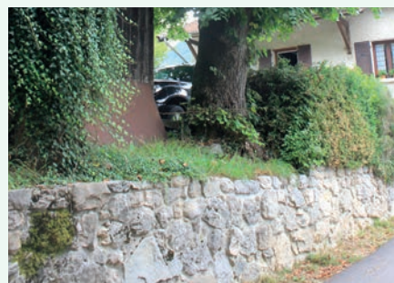
Appareillage hétérogène, joint en creux peu marqué et végétation en tête de mur - Saint-Martin-le-Vinoux
