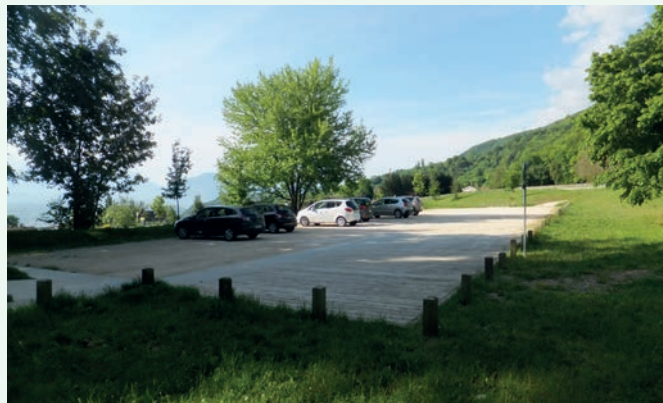
Aire de stationnement en bois et stabilisé renforcé à la chaux - Référence extérieure au territoire «Chartreuse» (Le bois des Vouillants, Seyssinet-Pariset)
