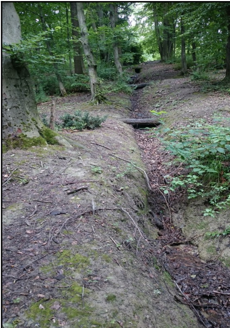
Photo 18: Axe de ruissellement / ravinement derrière le collège (1).
