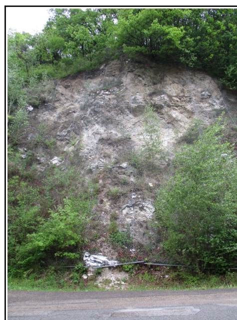
Photo 19: Grillage pendu au niveau de l'école
