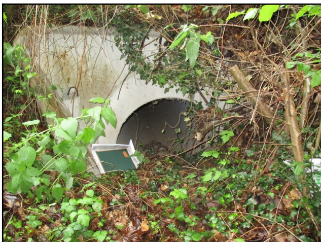
Photo 4: Buse en partie obstruée par des matériaux
