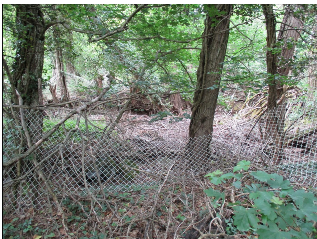
Photo 20: Fontis au-dessus de la cavité de La Touche
