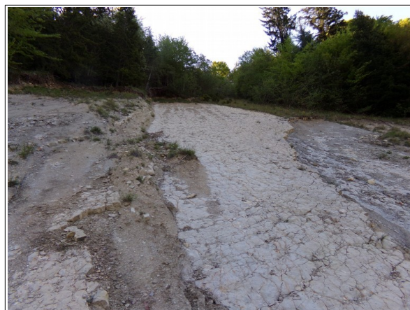
Photo 20: glissement du talus de la RD57 en limite communale de Sarcenas. On notera l'altération de la marne qui peut continuer à alimenter la zone de glissement.
