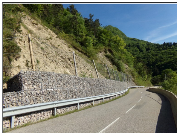
Photo 21: glissement de talus de la RD57 au sud de Mont-Quaix et gabions destinés à contenir les matériaux.
