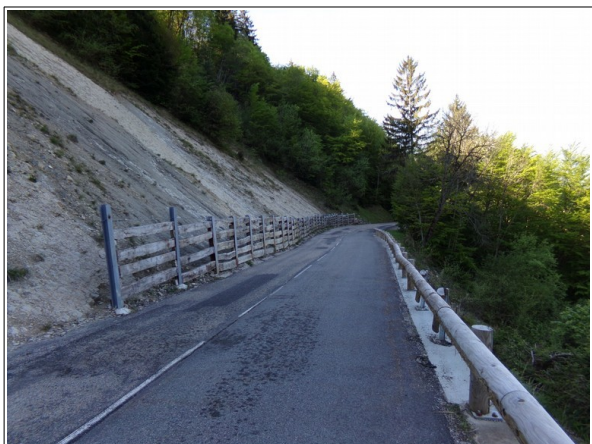
Photo 19: zone de glissement à l'amont de la RD57 en limite communale de Sarcenas. On notera le banc marneux mis à nu, le mur de soutènement de la route et la barrière piégeant les matériaux.
