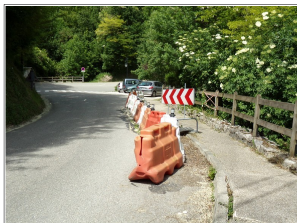
Photo 23: chaussée de la RD105a affaissée dans la traversée du village de Quaix.
