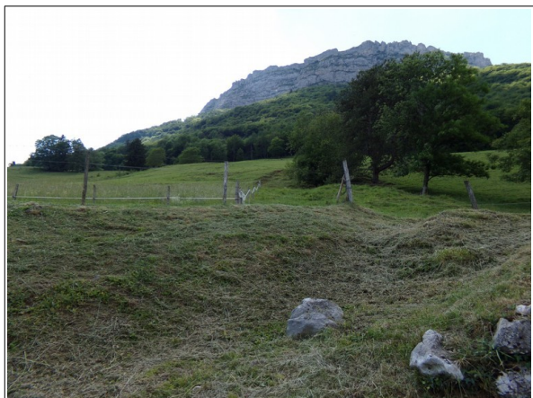
Photo 25: Traces d'instabilités au pied du versant du Néron, à la hauteur du hameau de la Croix-de-Chores.
