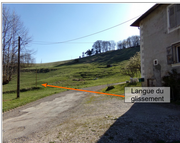
Photo 7: glissement de terrain dans une prairie à l'ouest du hameau de Croz. On notera la langue du glissement à l'aval du versant.
