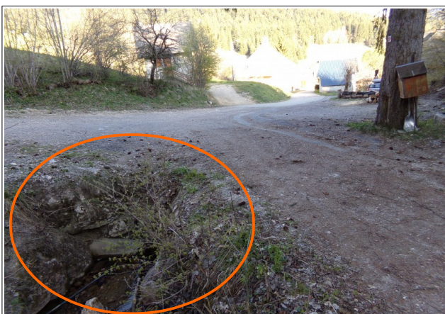
Photo 3: entonnement du busage du ruisseau du Pissou à l'amont du hameau de Croz. On notera sa conception inadéquate face à des écoulements torrentiels.
