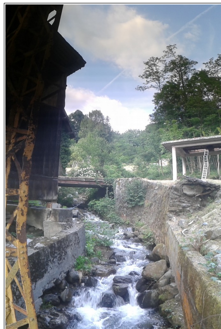
Photo 8: Fragilité des berges du Prémol au niveau de l'ancienne scierie.
