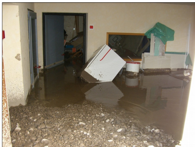
Photo 9 : Crue du Rif-Talon en 2006 à Malhivert : dégâts dans une maison (photo RTM).
