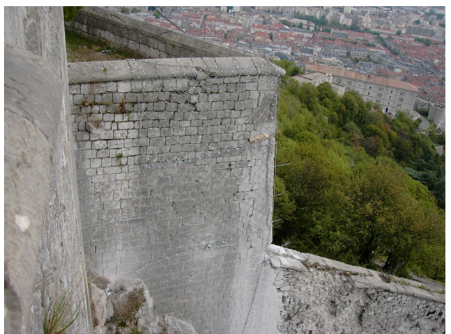
Photo 30 : Muraille en mauvais état, renforcé par un filet de câble
