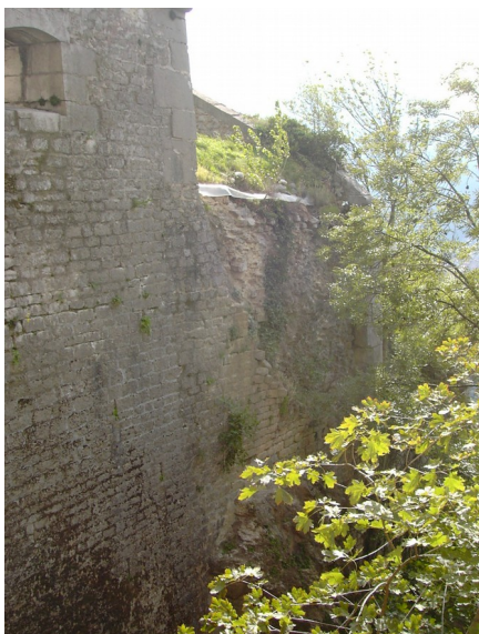
Photo 31 : Rupture de mur d'enceinte au droit du belvédère des Géologues
