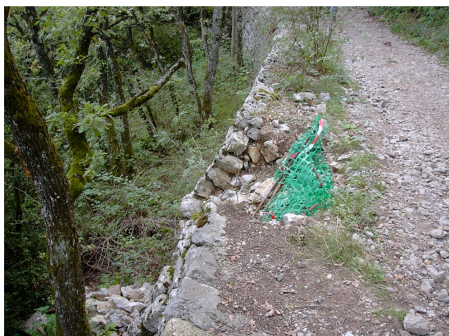
Photo 13 : Versant est du Jalla : impact d'un bloc sur un mur de soutènement
