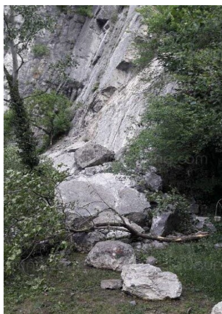
Photo 24 : Éroulement du 8 mai 2018 au niveau de la via ferrata (cliché DL)
